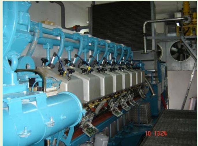
CHP unit in DH Burgas
